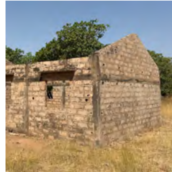
Vor Projektbeginn waren die Gebäude der Grundschule stark sanierungsbedürftig.
